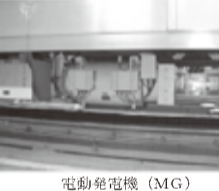
電動発電機 (MG)
