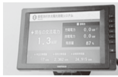
ソーラーパネルの発電を確認できるモニター
